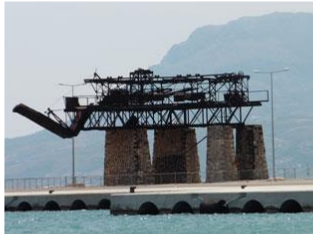
Verladerampen rosten vor sich hin, der Kai davor ist nagelneu.
